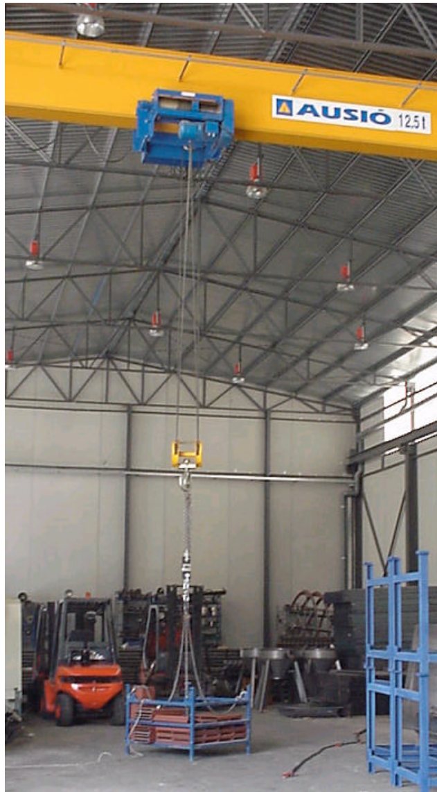
Figura 3.- En esta figura se puede observar el conjunto formado por el puente grúa, preparado para poder elevar la caja de carga y realizar su pesado gracias a la célula de pesaje de que se dispone.
