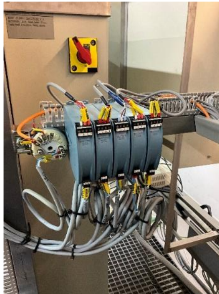
Figura 3.5: Transmisores asociados a los sensores de temperatura
