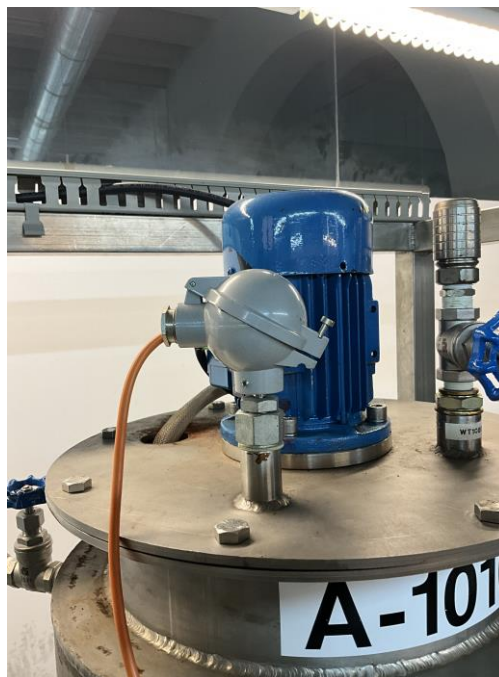
Figura 3.4: Sensor de temperatura en el reactor
