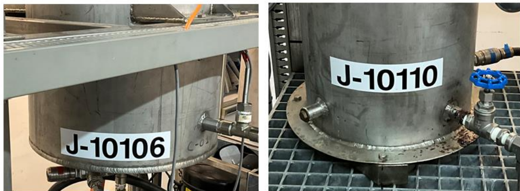
Figura 3.13: Resistencias del depósito J-10106 y J-10110
