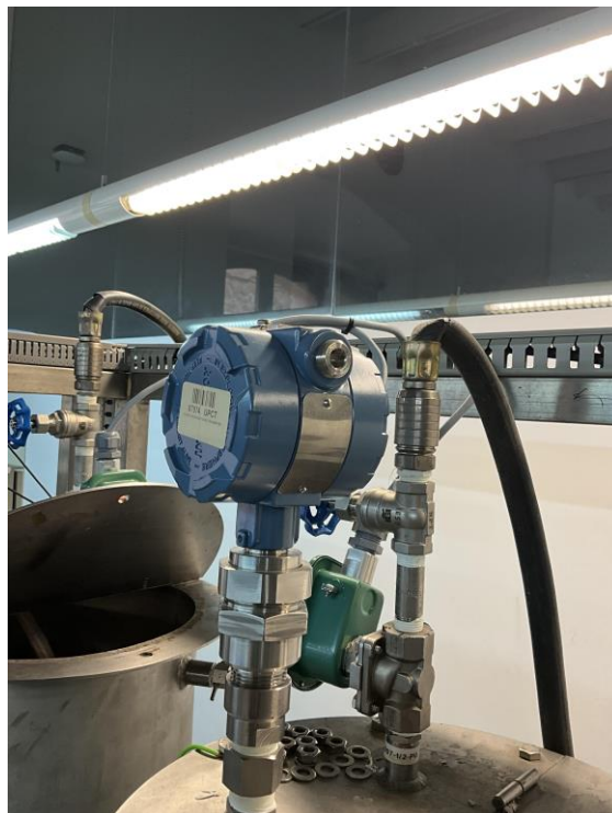
Figura 3.6: Sensor de nivel del depósito V-10102
