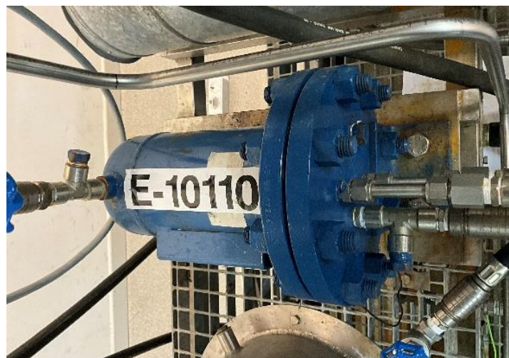
Figura 3.17: Intercambiador de calor E-10110
