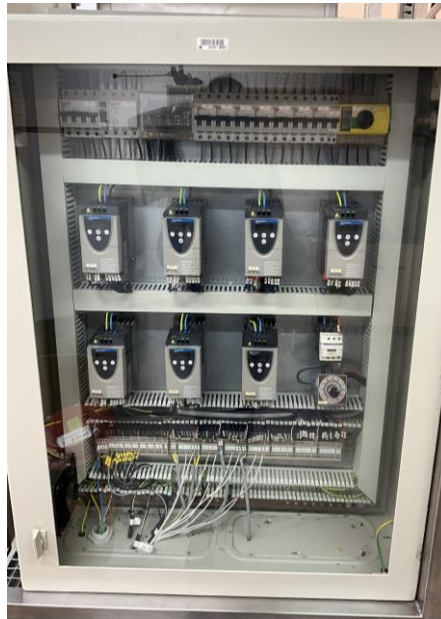
Figura 3.12: Armario de variadores de frecuencia
