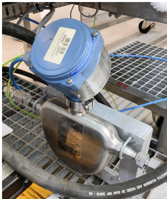
Figura 3.8: Caudalímetro en la línea de agua fría
