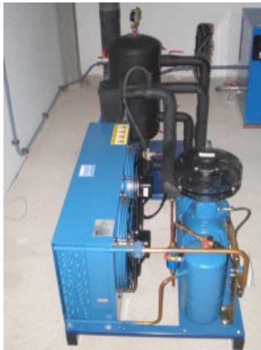
Figura 4: vista lateral de la máquina frigorífica.
