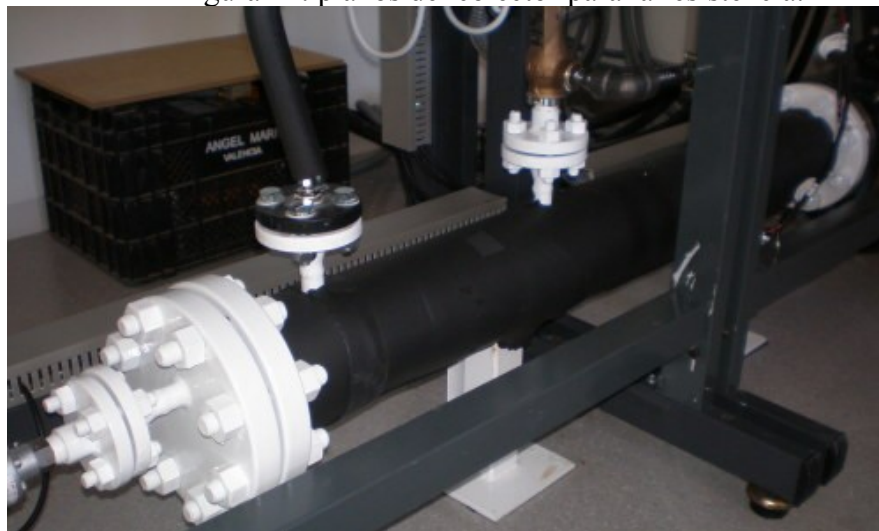
Figura 22: calentador y carcasa instalados.
