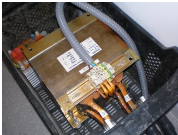
Figura 25: transformador en la instalación.
