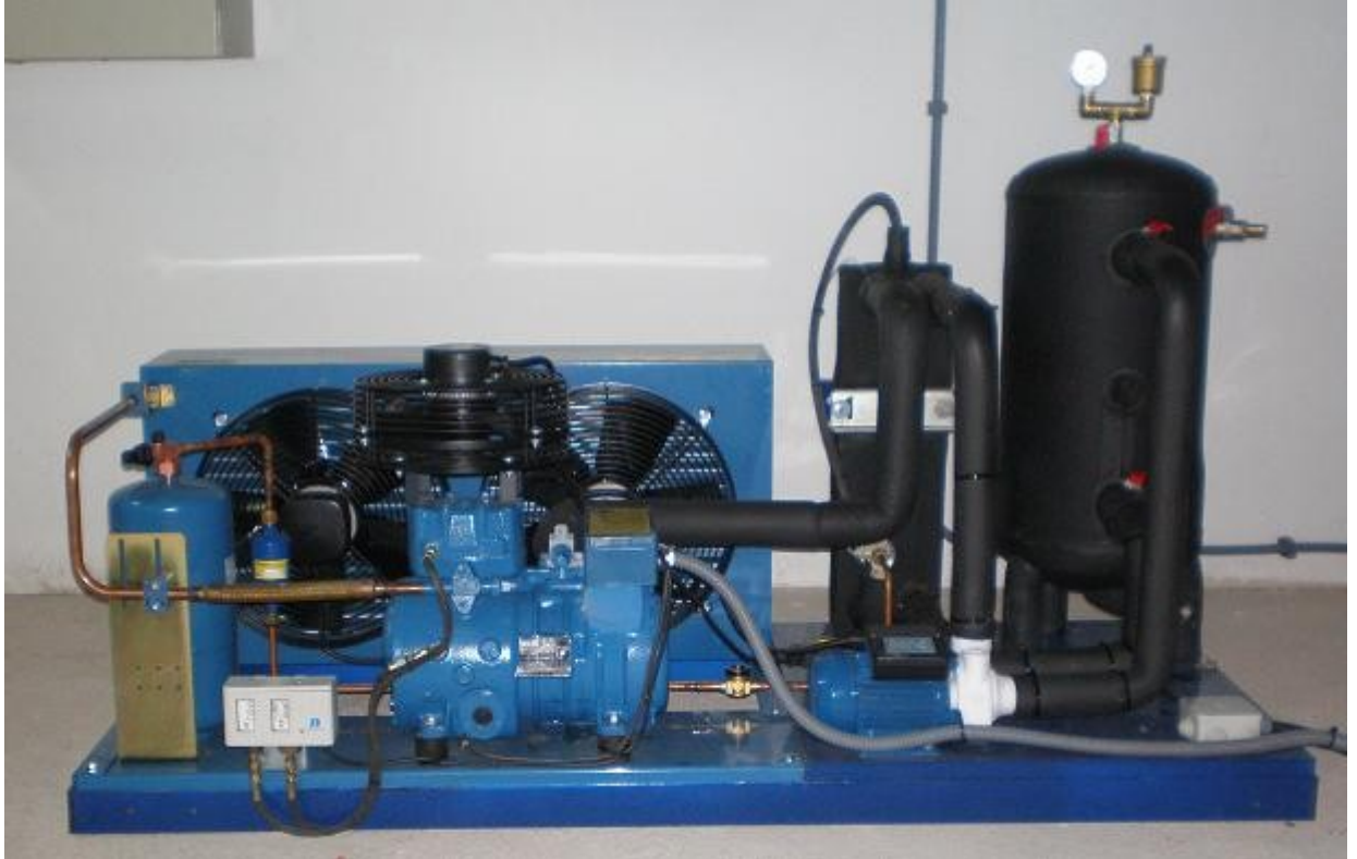
Figura 3: Máquina frigorífica utilizada para enfriar una mezcla glicolada (propilenglicol y glicol al 60% de glicol).
