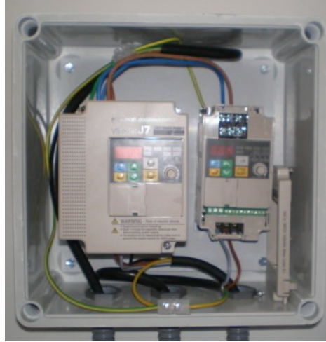
Figura 30: variadores de frecuencia.
