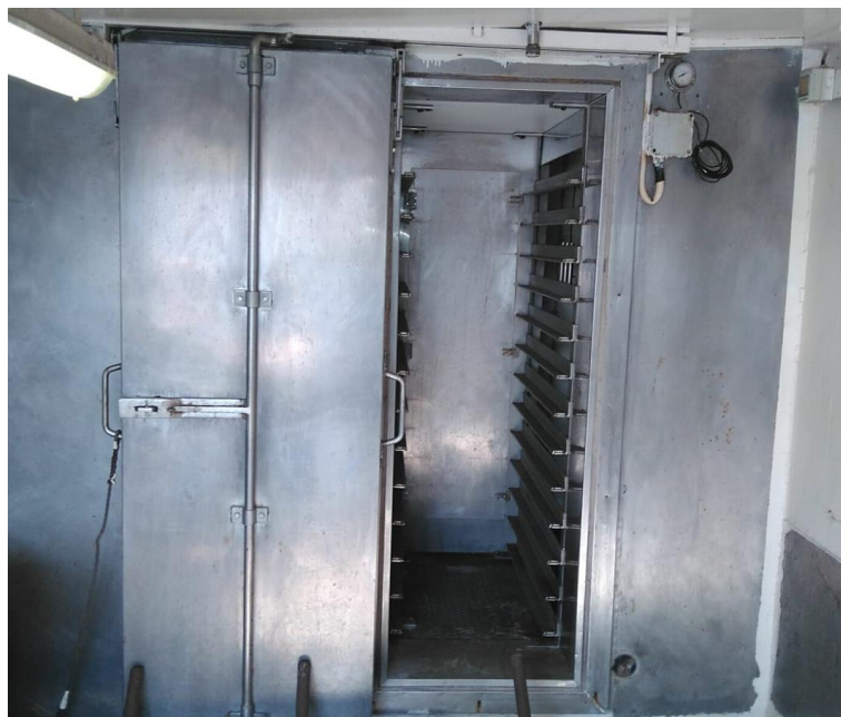
Figura 125. Túnel de congelación
