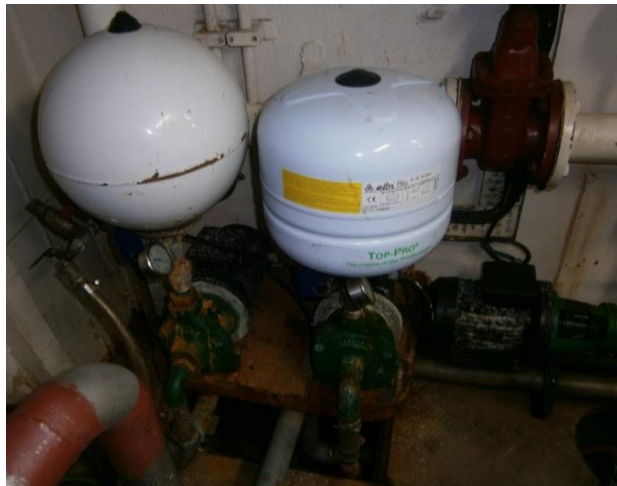
Figura 107. Bombas agua dulce / agua salada
