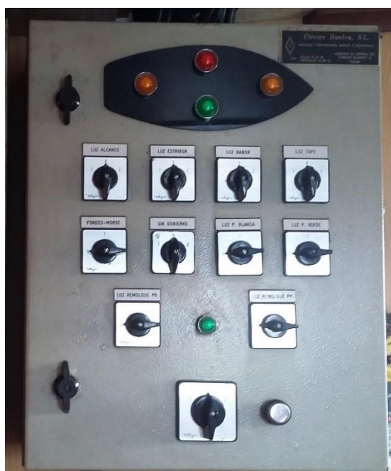
Figura 106. Cuadro de luces de navegación.
