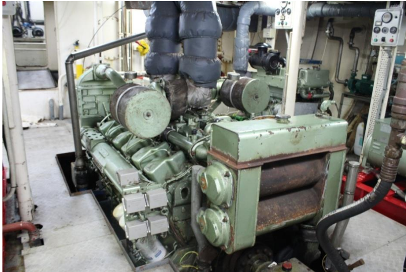
Figura 14. GUASCOR F360 instalado en cámara de máquinas.
