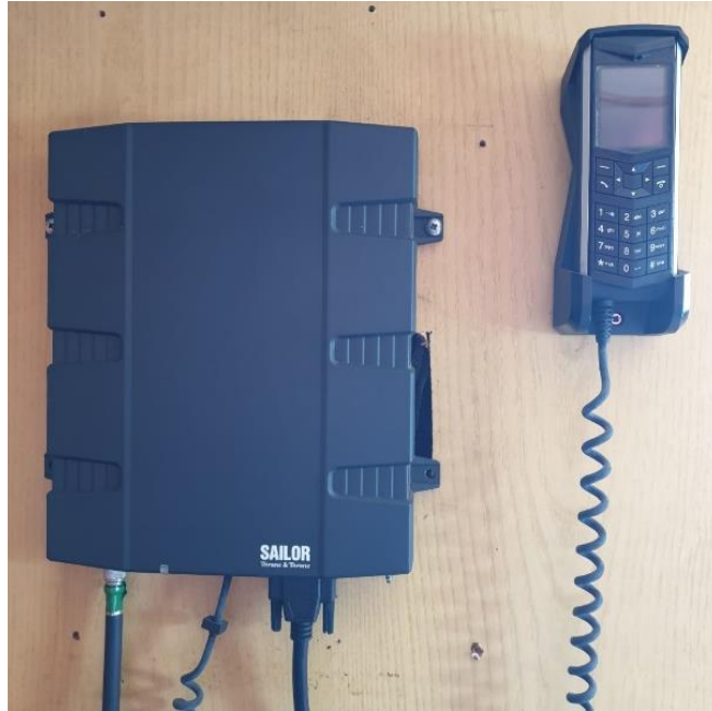
Figura 83. “FleetBroadband” SAILOR 150 instalado en el puente de gobierno.
