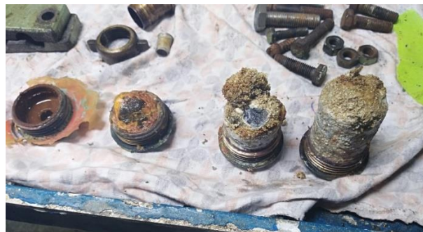
Figura 32. Ánodos de sacrificio del intercambiador.
