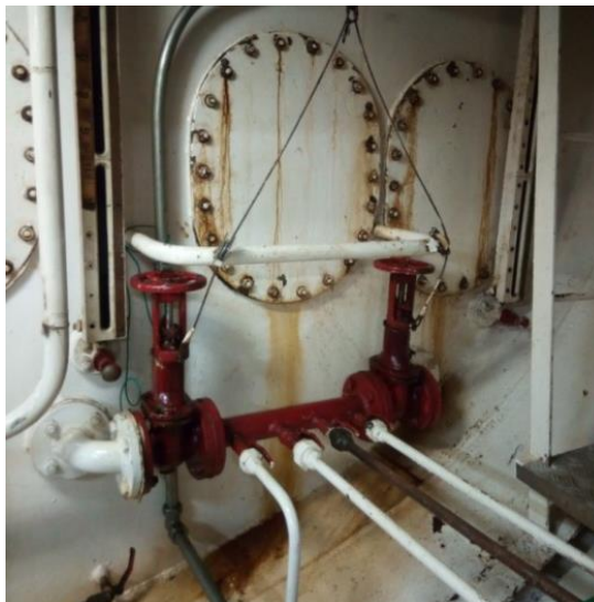
Figura 63. Tanques de servicio diario y válvulas de apertura
