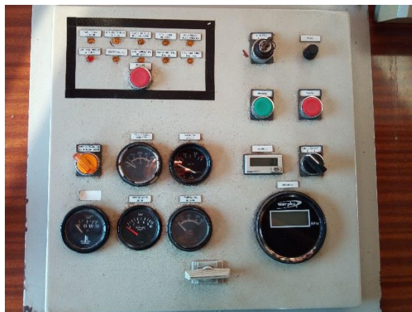
Figura 56. Cuadro control y alarmas del motor principal.
