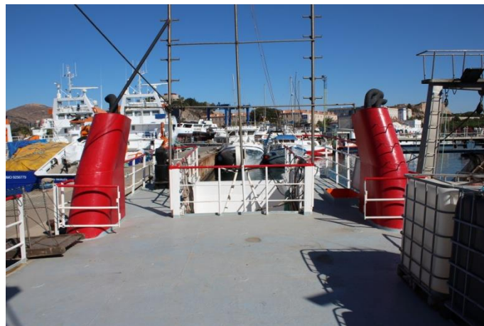
Figura 64. Chimeneas de exhaustación
