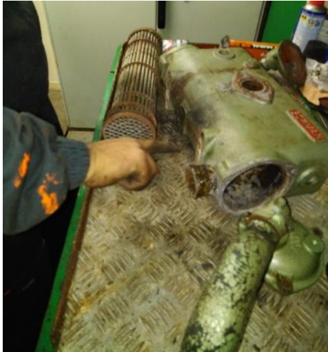
Figura 132. Limpieza del intercambiador de calor
