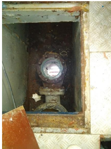
Figura 11. Toma de mar
