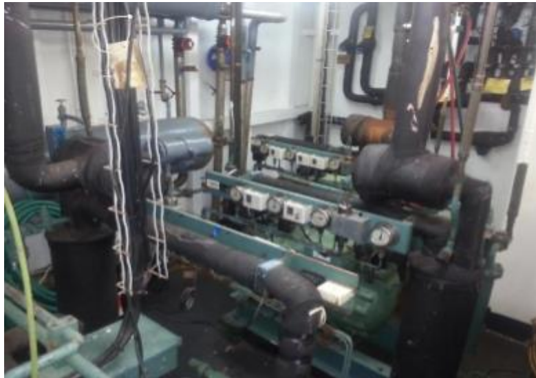
Figura 124. Cámara de compresores
