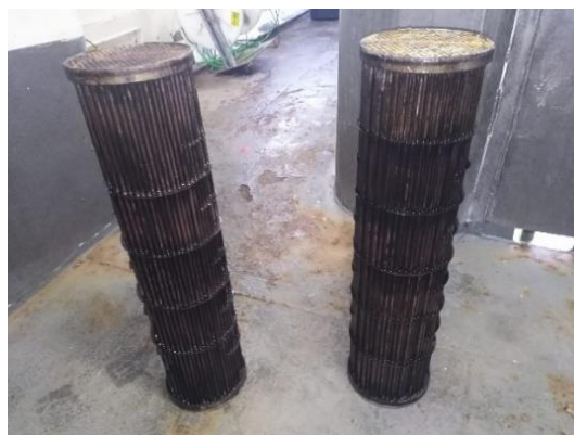
Figura 33. Tubos refrigeración de agua.
