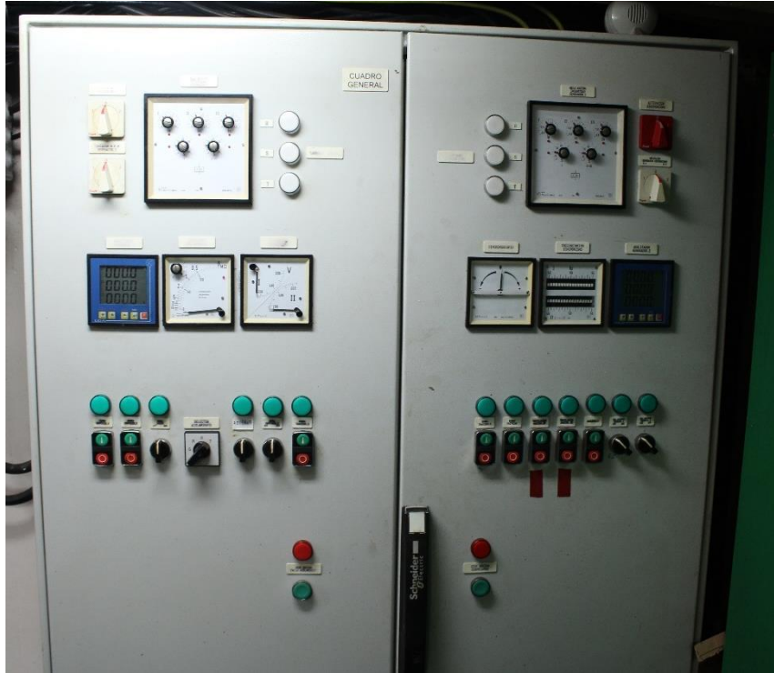
Figura 55. Cuadro eléctrico principal
