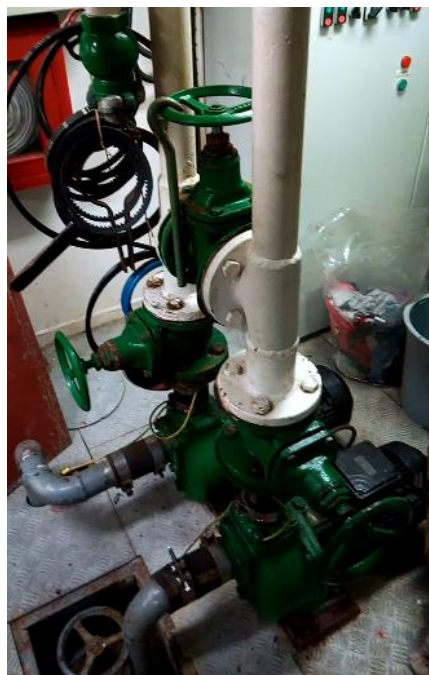
Figura 70. Bombas de achique.
