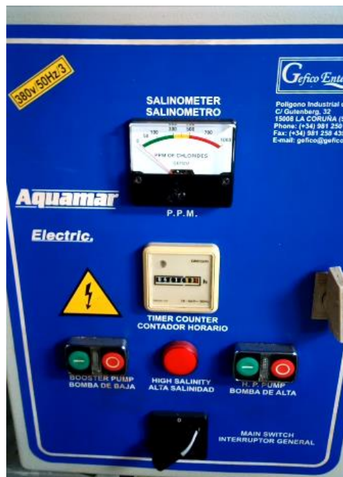
Figura 108. Cuadro de control de la planta de ósmosis.
