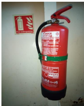
Figura 71. Extintor de polvo seco
