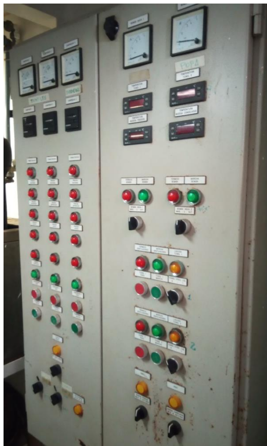
Figura 129. Cuadro eléctrico sistema frigorífico y de congelación.
