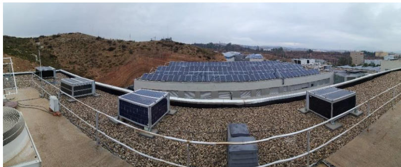
Figura 3. PV Cubes instalados en la azotea del Instituto Universitario de Investigación en Óptica y Nanotecnología de la Universidad de Murcia. Fuente: [7]
