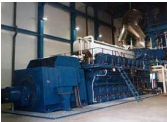
Ilustración 8. Fotografía grupo diesel para cogeneración, con motor MAN tipo 16V 40/45
