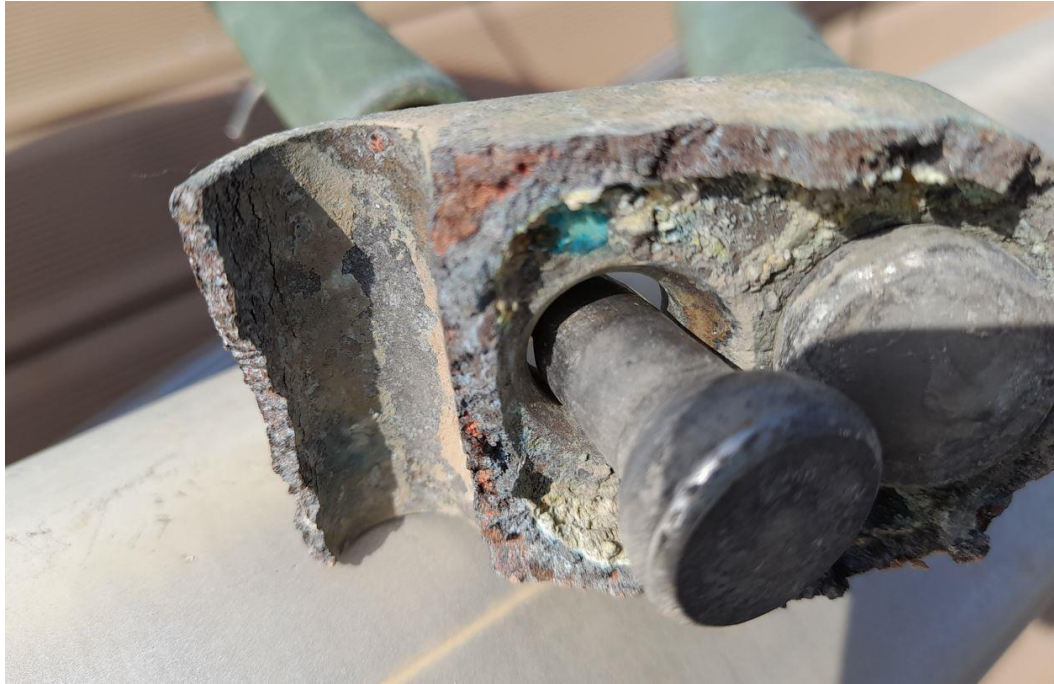
Ilustración 16. Ejemplo elemento jarcia discontinua dañado.
