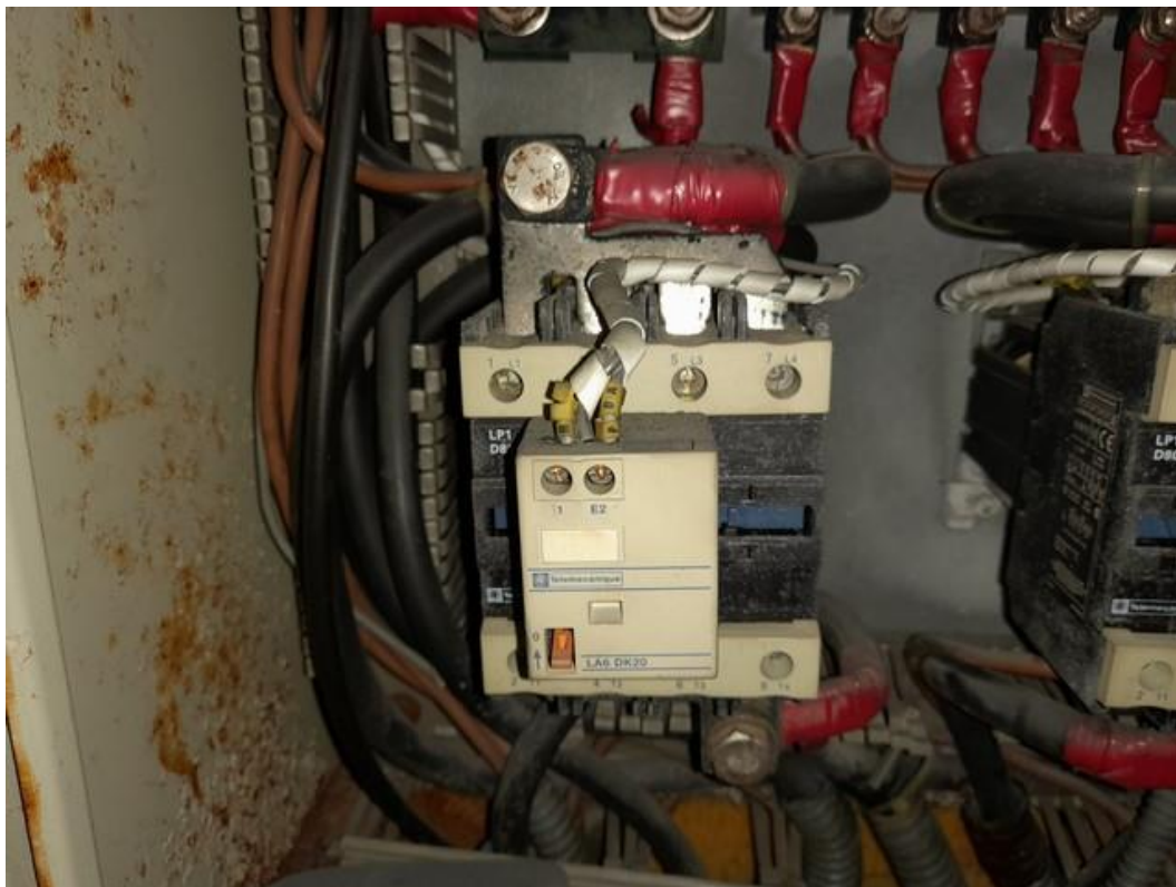
Ilustración 20. Ejemplo componente eléctrico averiado.
