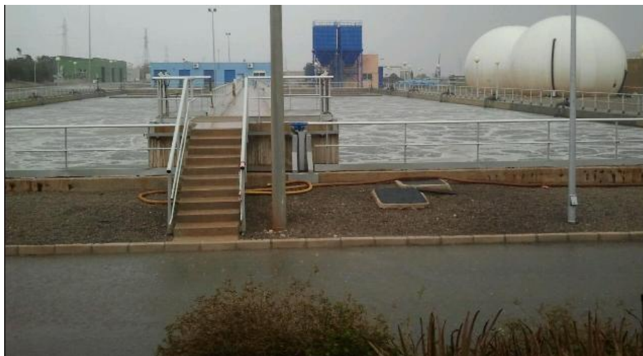
Figura 8. Reactores biológicos de la EDAR Cabezo Beaza. Fuente: Google Maps, 2017.
