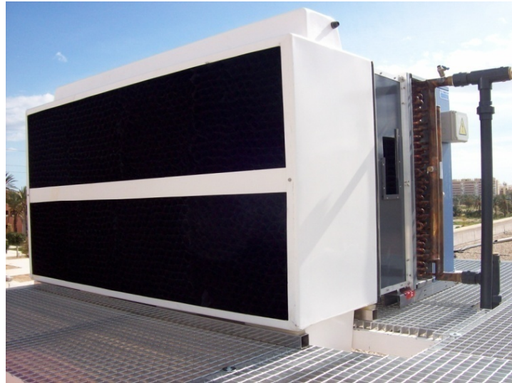
Fig. 3. Prototipo. Aero-refrigerador con pre-enfriamiento adiabático
